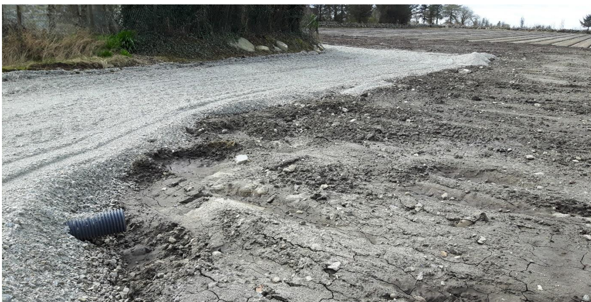
Figur 47: I enden av vegen er det innlagt drenerør. Overvatnet vil gå gjennom dette og ned i kum. Området rundt drenerøyra bør reinskast jamt.
