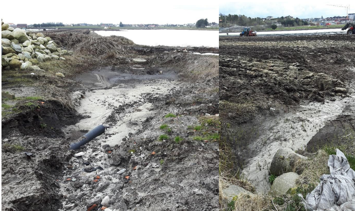
Figur 28: Eit sedimentasjonsområde med heva utløp ligger rett vest for den tversgåande traktorvegen som går midt i teig 22 (venstre). Eit liknande tiltak bør lagast til ved røyrutløpet i vestre del av teigen, rett ved Bøkanalen (høgre).
