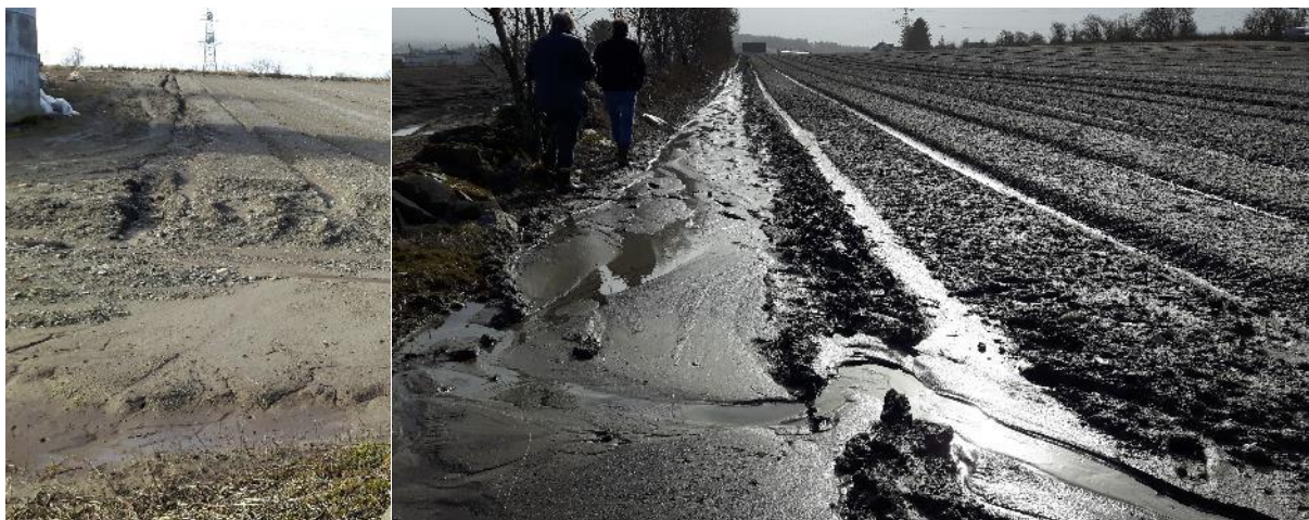
Figur 82: Det er tydelege teikn til mykje avrenning, erosjon og transport av finpartikulært materiale i dei ulike delane av «Vidar».
